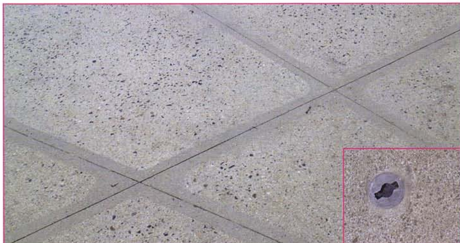
La place accueille un marché hebdomadaire, d'où l'obligation d'utiliser un revêtement résistant, facile à entretenir par nettoyage sous pression.
